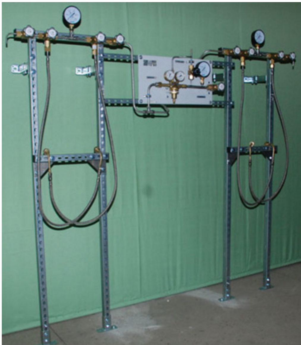
Унифицированная рампа для инертных газов и кислорода на 2 моноблока в каждой ветви
